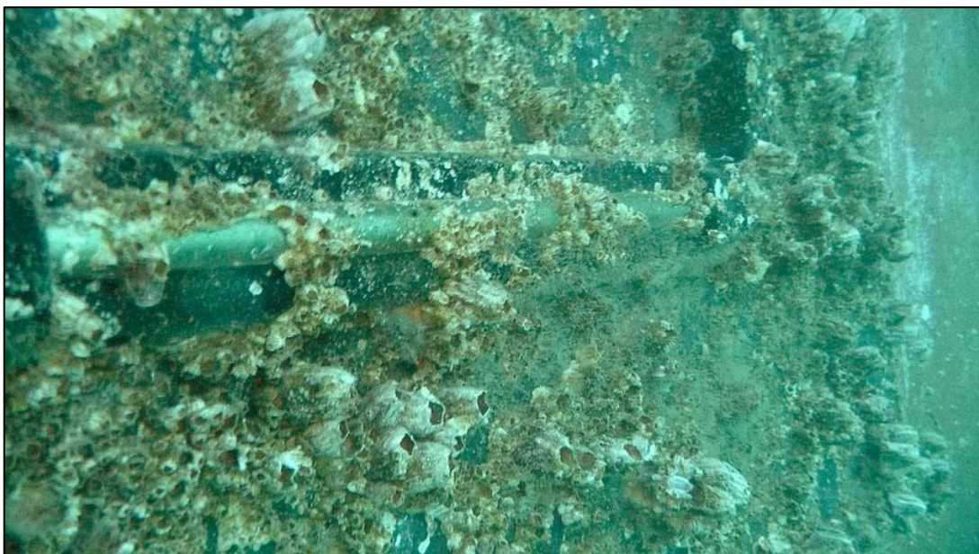
Figura 6 – “Incrustações marinhas” fixadas em estrutura submersa [Disponível em: < http://indianwildlifeblog.com/2014/06/how-to-prevent-marine-growth-on-marine-vessels >. Acesso em: 17 jul. 2015]
